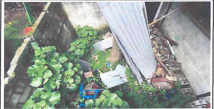
Foto 4: lamina destruida y en mal estado
