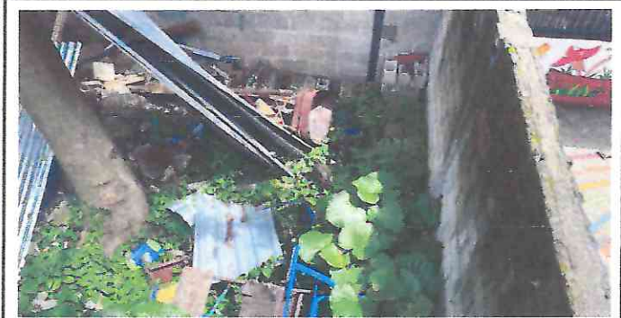
Foto 3: lamina en mal estado
