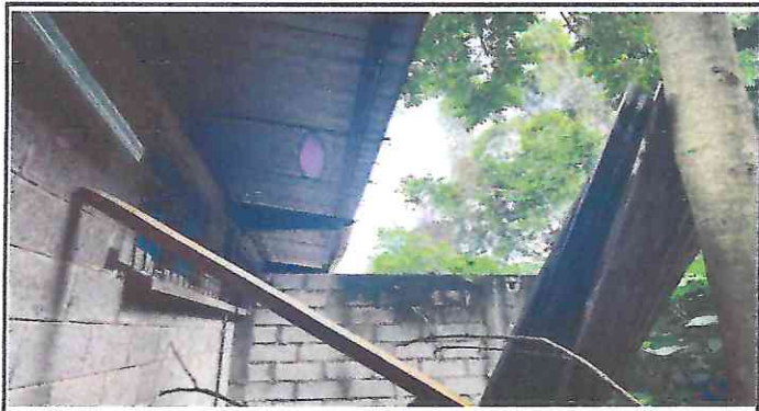
Foto 2: lamina en mal estado
