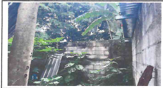
Foto 1: lamina en mal estado
